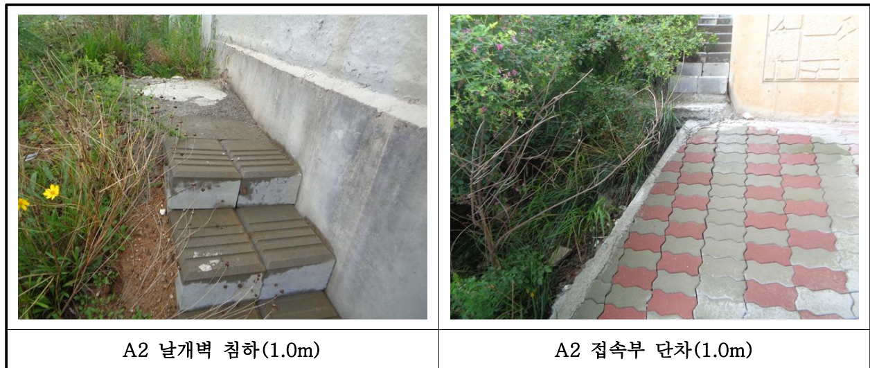
【사진 9.3.9】 교대 손상현황
